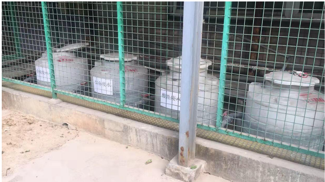
图 7.1-2 废水分类收集罐照片
